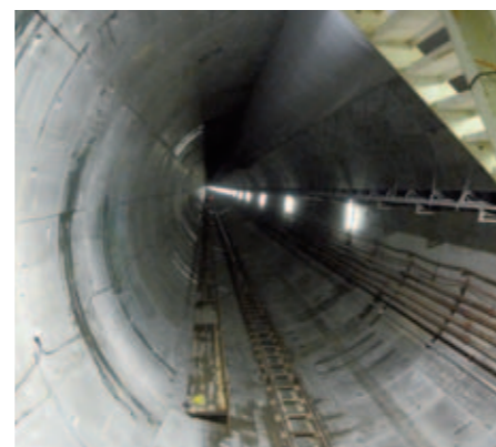
Wycieki przed zastosowaniem folii drenażowej.
